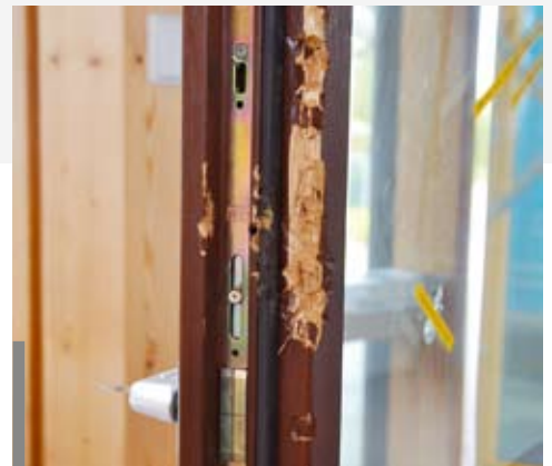
Einbruchsspuren am Fenster
